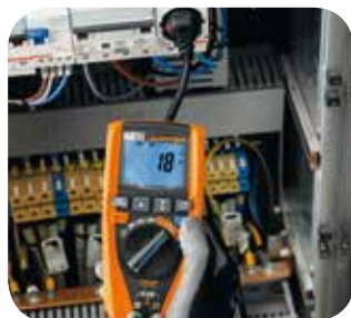
Impedanzmessung ohne RCD-Auslösung
