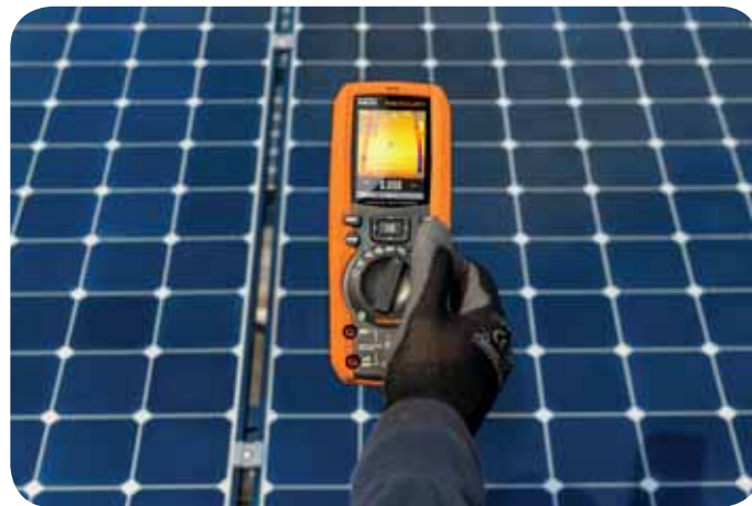
Campo FV: Analisi Termografica.
