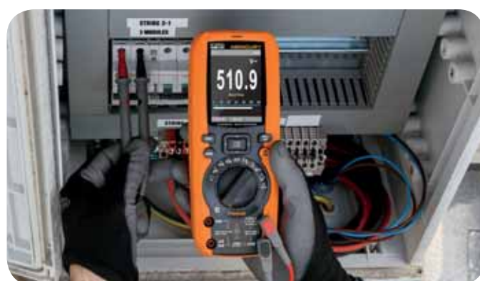
Stringa FV: Misura di Voc.
