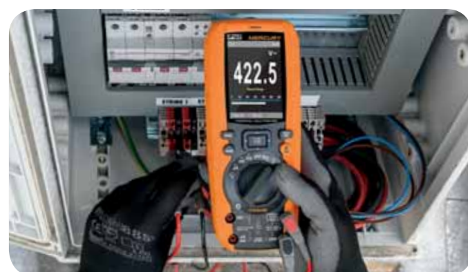
Stringa FV: Misura di Vmpp.
