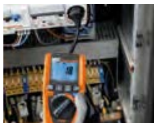
Impedanzmessung ohne RCD-Auslösung
