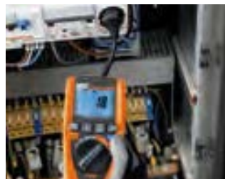
Impedanzmessung ohne RCD-Auslösung
