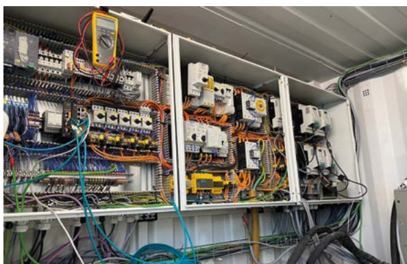
Schaltschrank der Tunnelbohrmaschine mit Bender Komponenten
