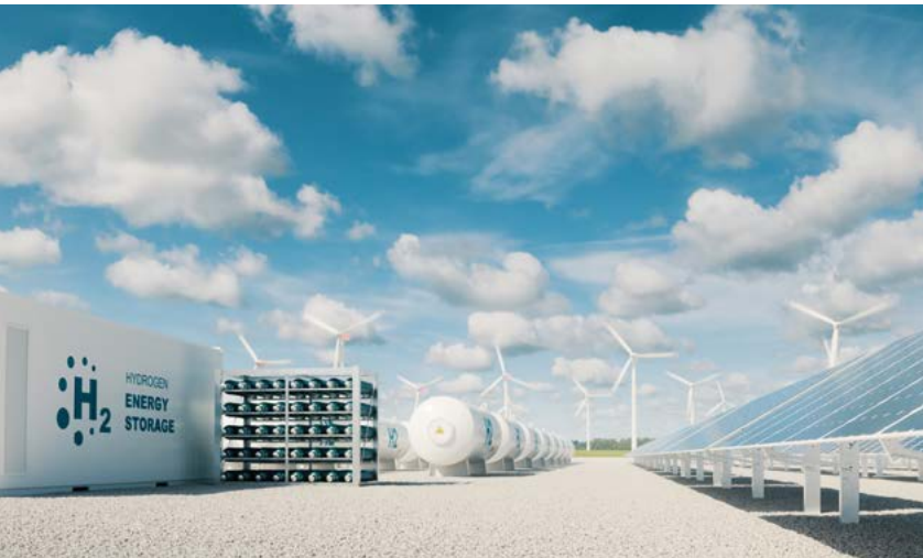
Wasserstoff kann helfen die 50 Hz Netzstabilität zu sichern.
