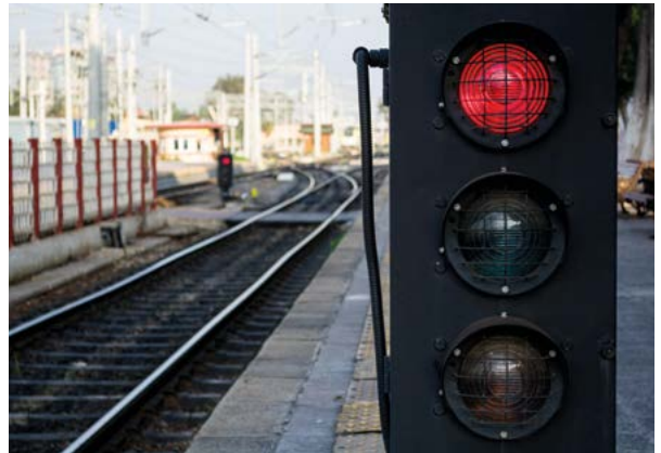
Seit über 20 Jahren ist Bender UK ein führender Anbieter für elektrische Sicherheit im Bahnverkehr.
