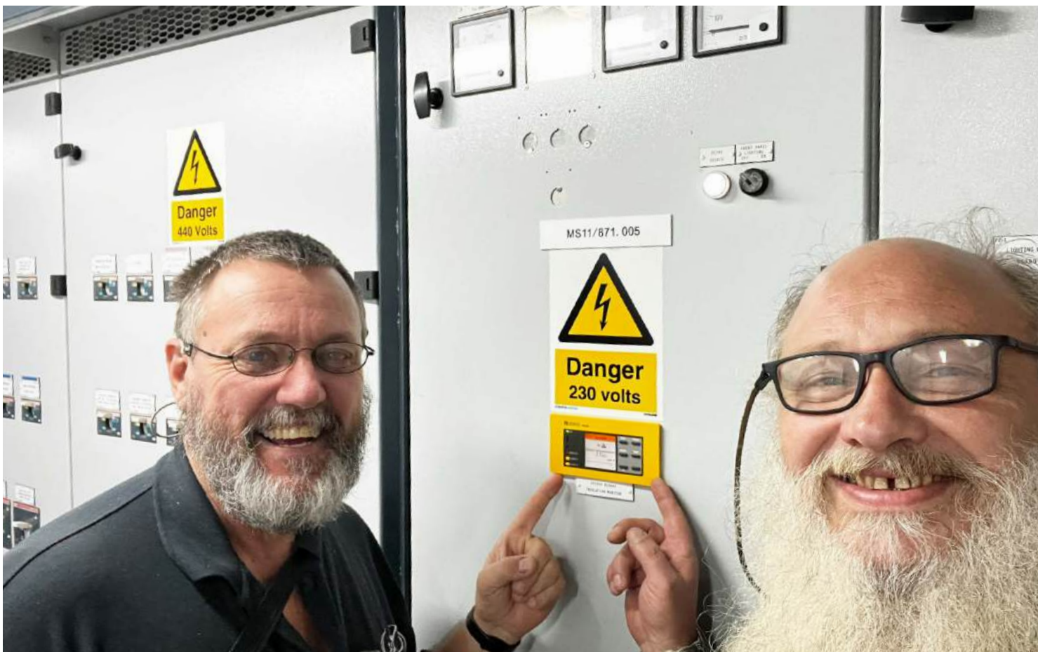
Renier Marx, Chief Electrician, Global Mercy®, Mercy Ships, und Alistair Macdonald, Electrical and Control Technician, freuen sich über die automatische Fehlersuche in der Haupt- und Notschalttafel.
