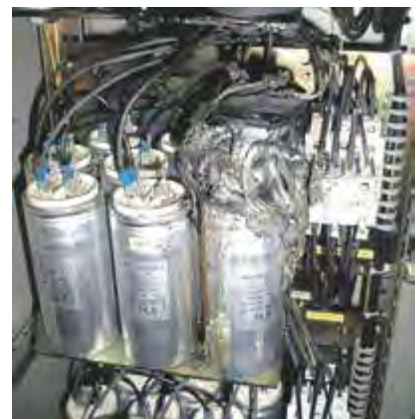
Abb. 6: Zerstörter PP-Blindleistungs-Kompensationskondensator: Ein schleichender hochohmiger Masseschluss hat zum kompletten Aufschmelzen des Kondensators und einem lokalen Brandherd geführt.
