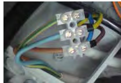
Abb. 7: Hier wurden N- und PE vertauscht
