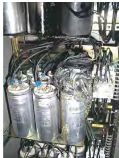
Abb.: Zerstörte Kondensatoren durch Oberschwingungen
