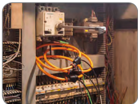
Messung Einsatz der flexiblen Stromwandler
